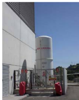
Instalaciones empresa A con depósito de la empresa B, suministradora.
